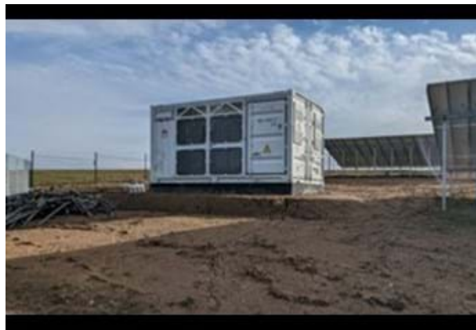
Figur 8. Eksempel på parktransformer.
