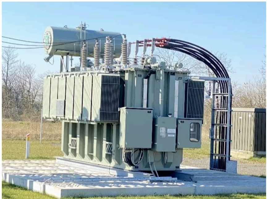
Figur 9. Eksempel på Stationshus og Forsyningstransformer
