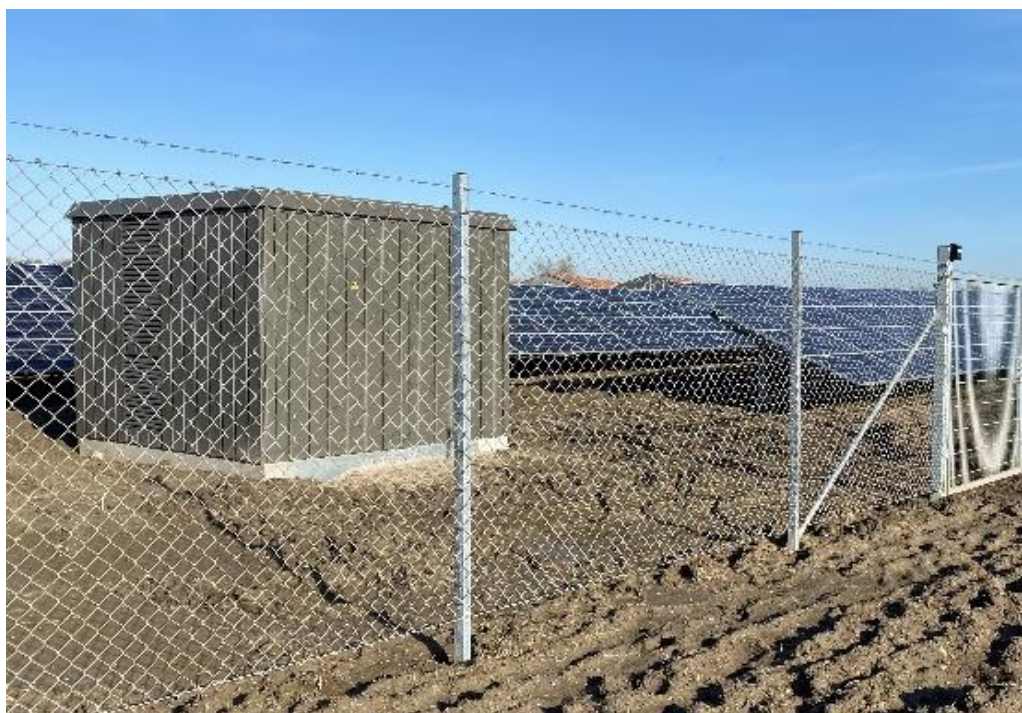
Figur 3-14. Foto eksempel på parktransformer. Kilde: Ecosolar.
