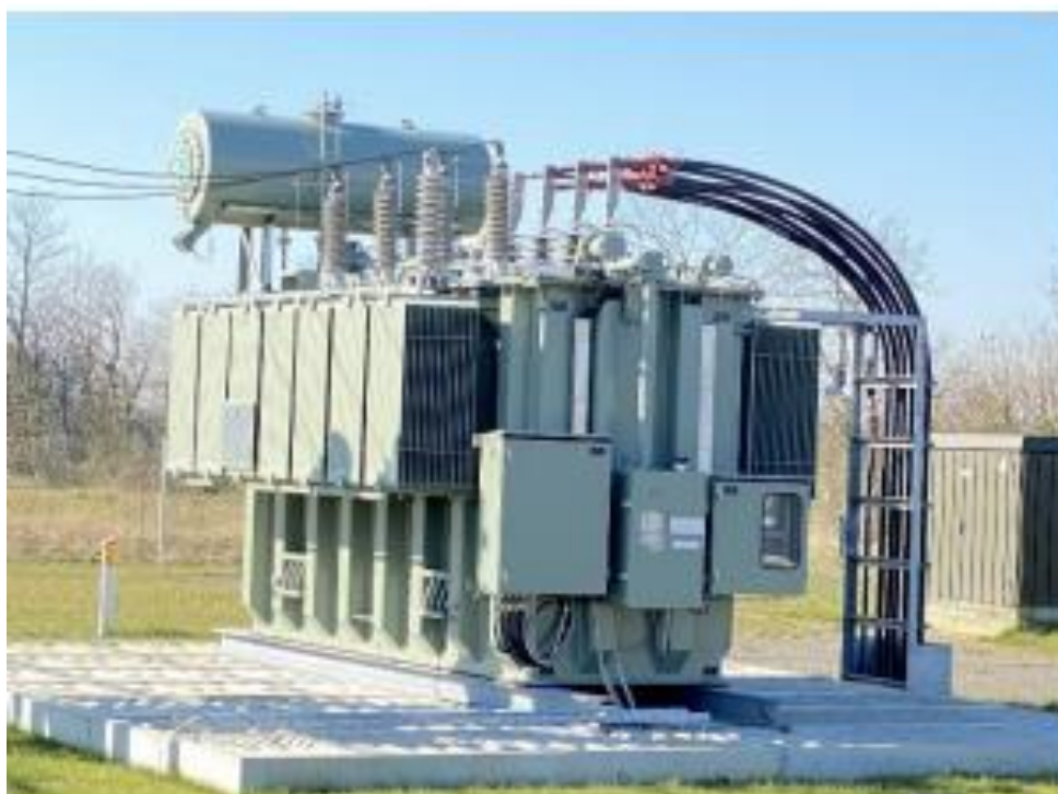
Figur 3-15. Eksempel på forsyningstransformer. Kilde: Ecosolar.
